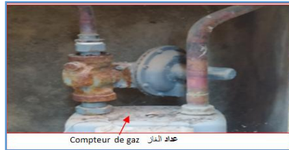
Compteur de gaz عداد الغاز
