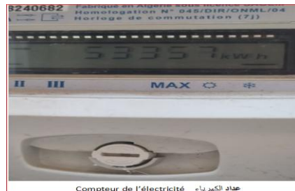
Compteur de l'électricité عداد الكهرباء
