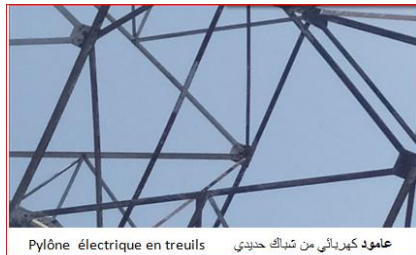
Pylône électrique en treuils عمود كهربائي من شبك حديدي
