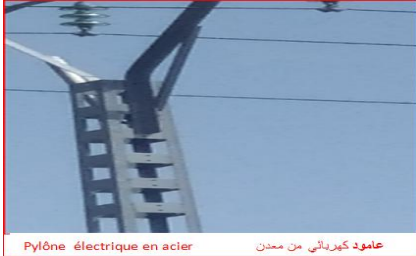
Pylône électrique en acier عمود كهربائي من معدن
